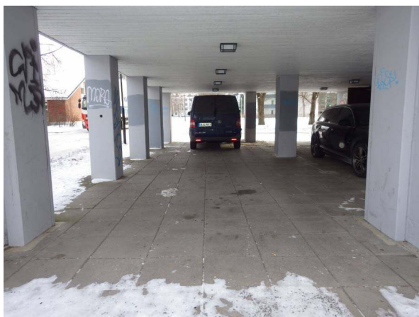
3. Pihapäällysteet ovat tyydyttävässä kunnossa.
