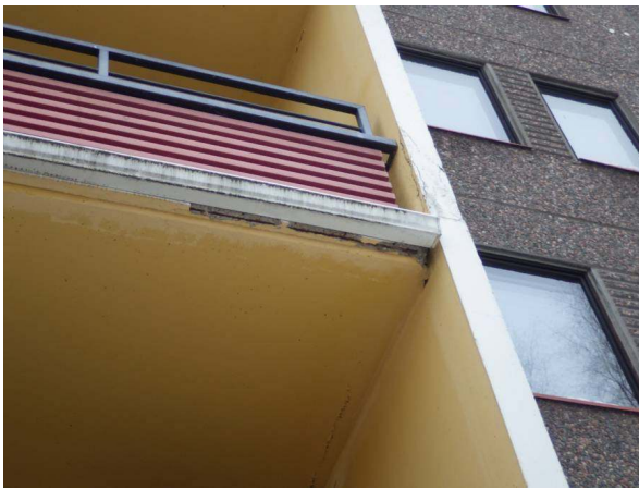
15. Parvekelaatan reunassa esiintyy pakkasrapautumista ja terästen korroosiovaurioita.
