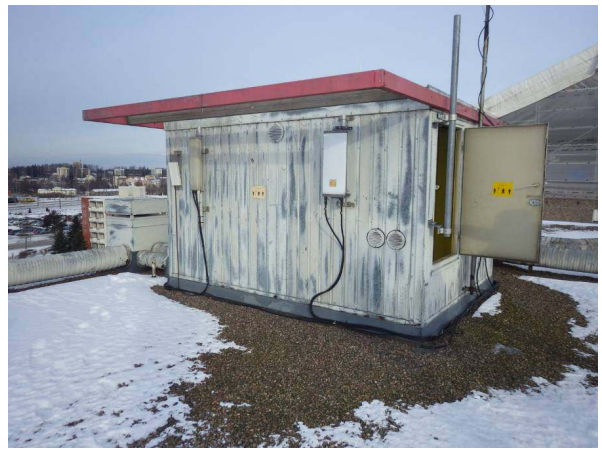
18. Vesikaton maalatuissa teräsrakenteissa esiintyy haalistumista.
