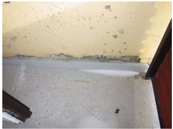
16. Rapautumista parvekkeen pielirakenteissa.
