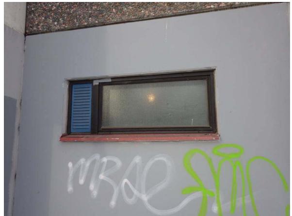
8. Ulkoseinien alaosissa on graffitipiirroksia.
