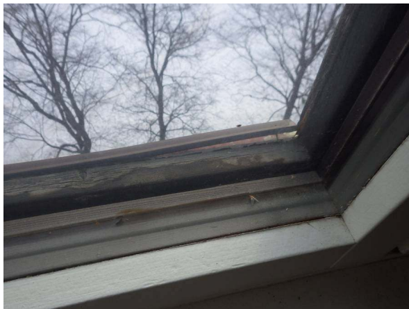
11. Alkuperäisissä ikkunoissa esiintyy ikääntymisen ja sääräsituksen jättämiä jälkiä.
