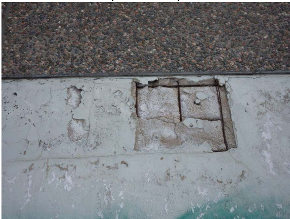
9. Vaurioita ulkoseinien betonirakenteissa.
