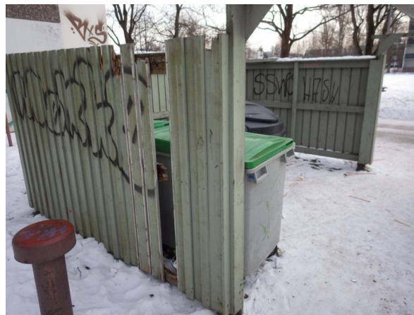
5. Jäteaitauksessa esiintyy lahovaurioita.
