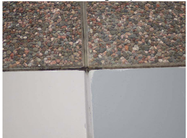
10. Elementtisaumojen uusimiseen tulee varautua.
