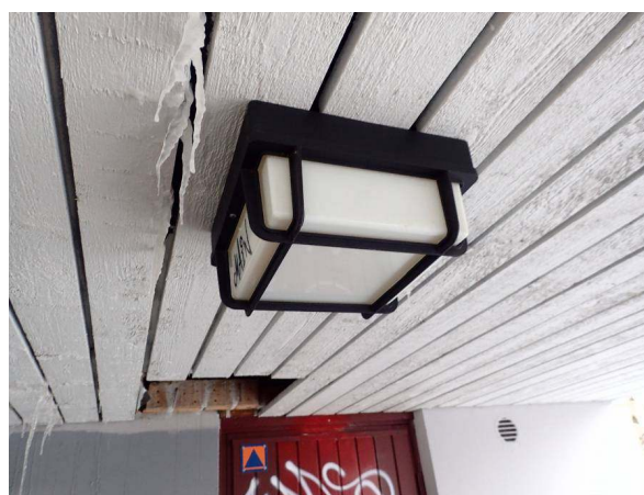
44. Rakenteisiin asennettu valaisin.
